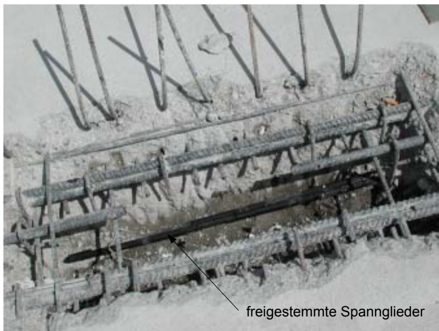
Bild 4: Im Bereich der Spannglieder (Achse 204) aufgestemmt Deckenplatte
